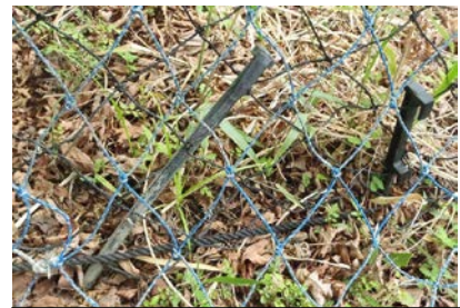
ネットの被害の様子。杭抜けです
