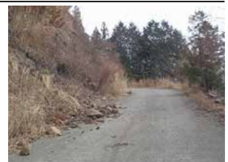
高丸山町道の法面土砂に注意
