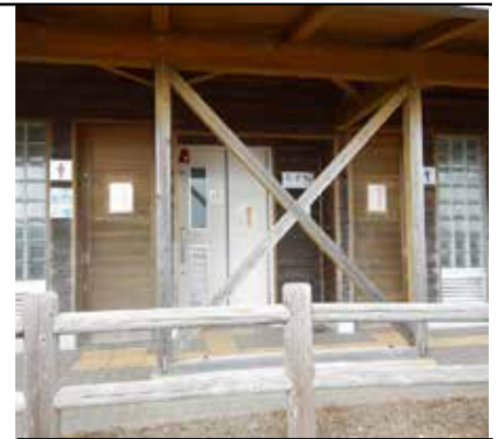
②高丸山のエコトイレは、凍結防止のため冬季は閉鎖しています
