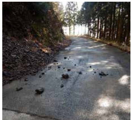
道路の上には、法面からの尖った石が転がっています。車両走行時は注意です。
